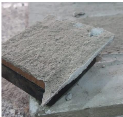
Figura 4- Ruptura da camada de argamassa
